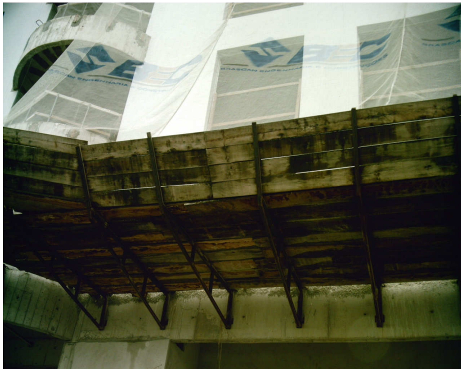
Fig. 01 Plataforma primária de proteção (apara-lixo)
